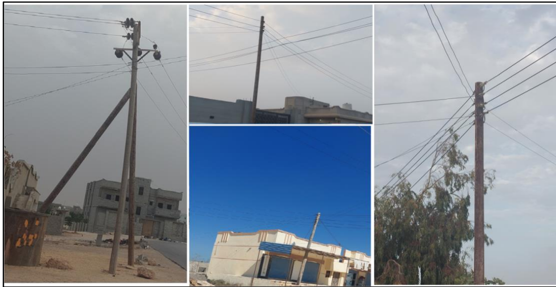
صورة رقم (9) تلوث بصري نتيجة كثرة وتشابك خطوط الكهرباء الهوائية
