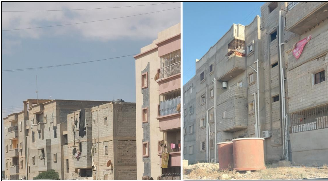
صور رقم (3) وحدات سكنية غير مكتملة البناء
