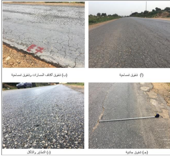
شكل (5): بعض أنواع العيوب التي تم ملاحظتها من خلال دراسة طريق البيضاء - عمر المختار
